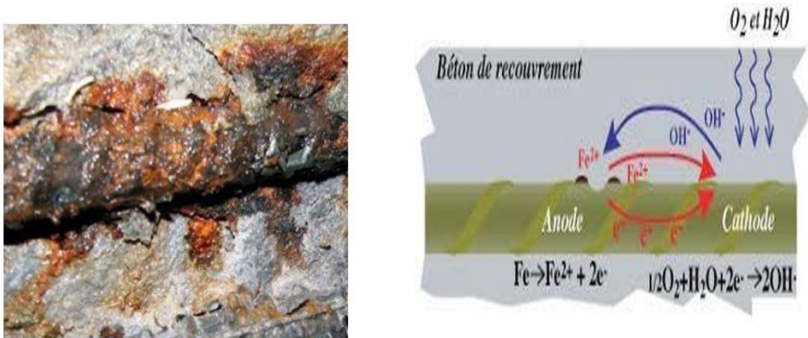
Figure I.4 : Dégradation due à la corrosion des armatures [20].
