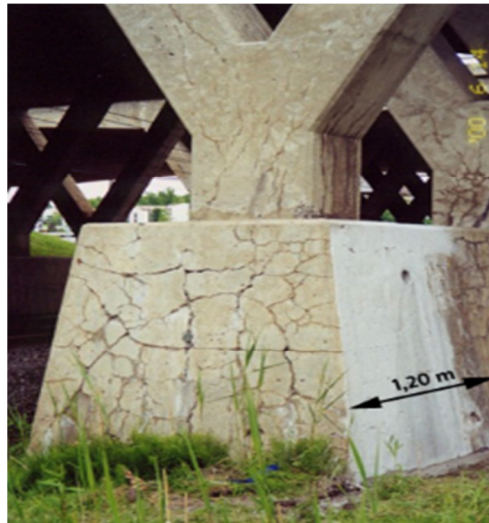
Fig. II.5: Exemple de béton dégradé par l'alkali-réaction.
