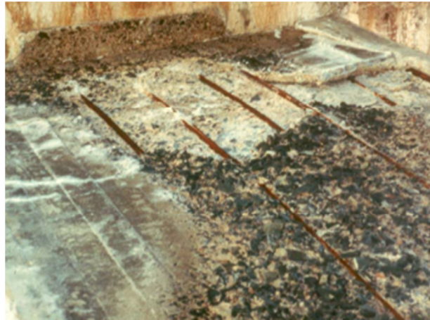
Fig. II.20: Délamination du béton
