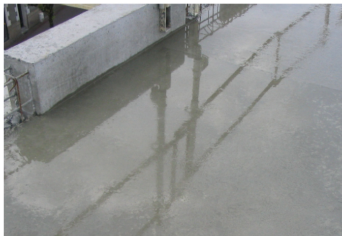
Fig. II.21 : Ressuage du béton après vibration
