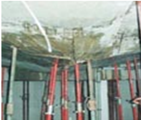
Fig. II.19: Fissuration et éclatement du béton sous charges trop importantes
