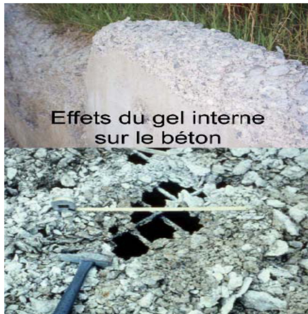
Fig. II.25 : bétons affectés par le gel interne
