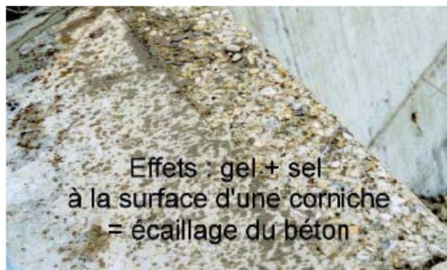
Fig. II.26: béton affecté par l'écaillage
