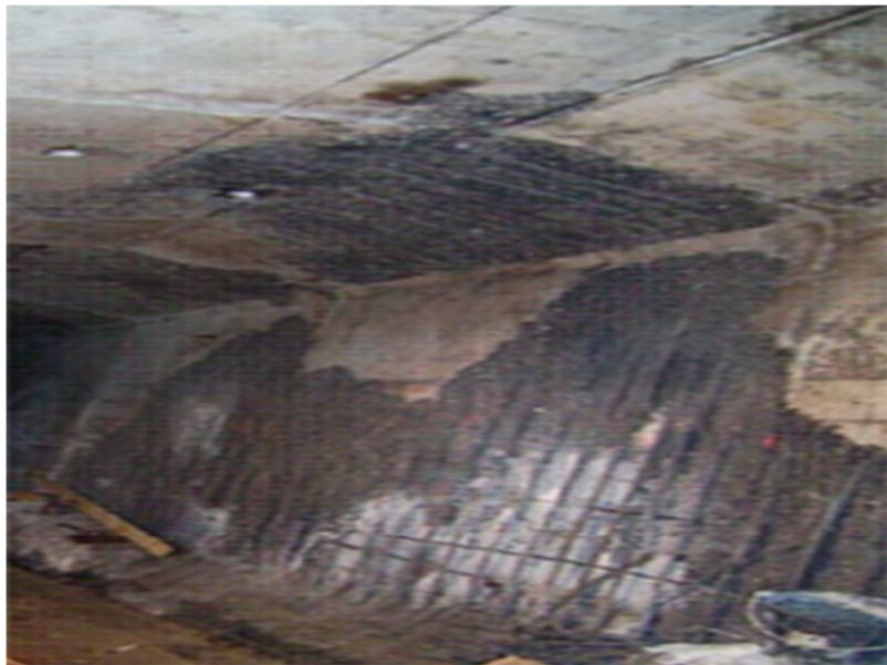
Fig. II.22 : structure en béton armé dégradée par le feu
