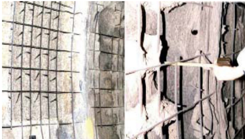
Fig. II.23 : béton après un incendie
