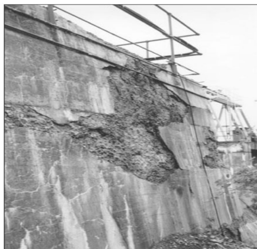
Fig. II.24 : Exemple de dommages causés par le gel-dégel
