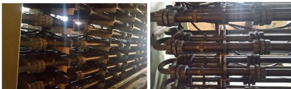
Fig IV.6 les cellules de l'électro-chloration.
