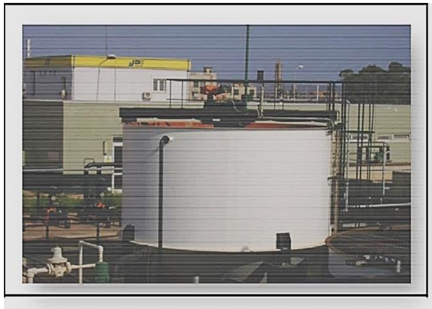
Figure II.6 : Épaississeur de boues.
