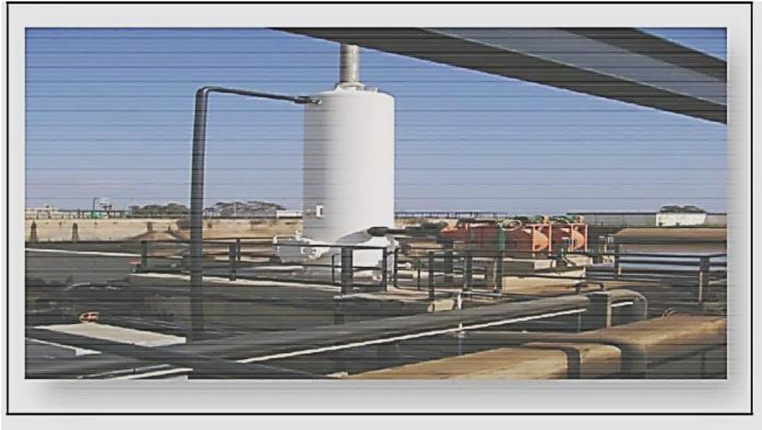
Figure II.2 : Ballon de refroidissement et dégazage
