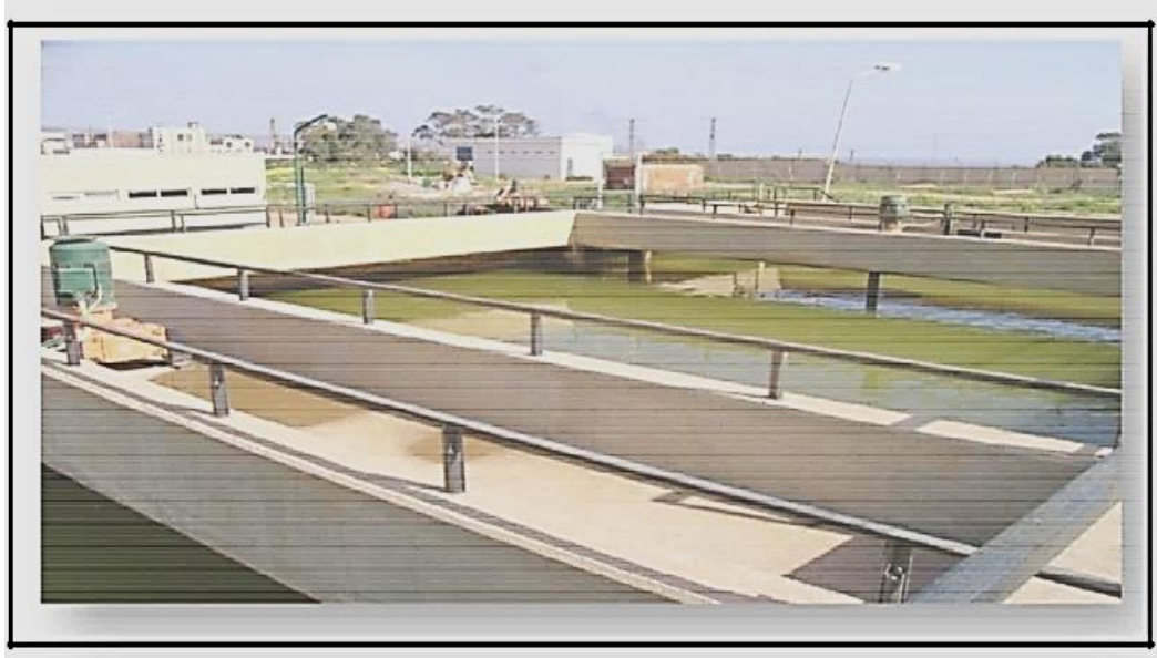
Figure II.5 : Bassin d'épuration biologique.
