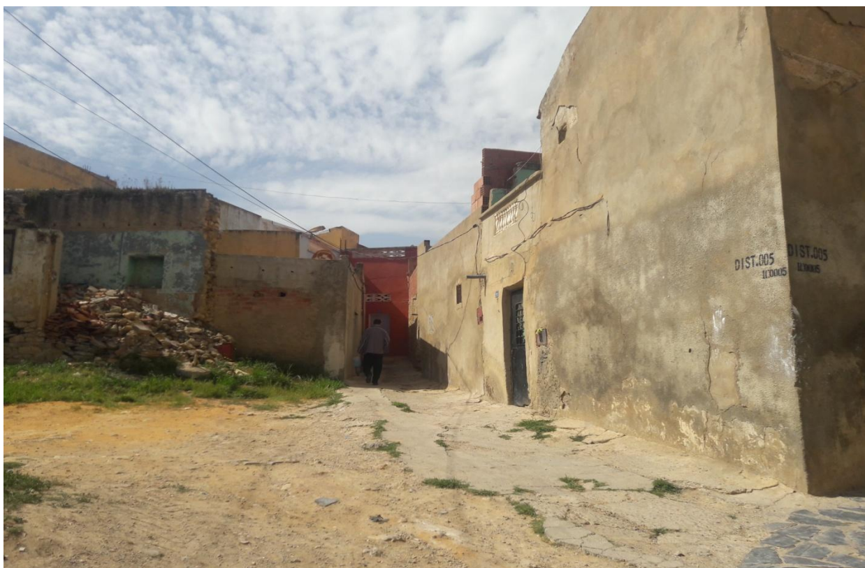
Construction en ruine à rénover
