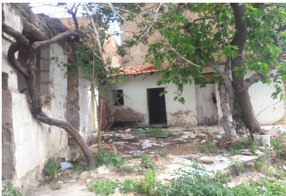
Construction en ruine à rénover
