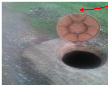
Conduite d'assainissement avec des vapeurs d'air contaminés
