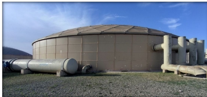
Figure 18: système de stockage d'eau traitée
