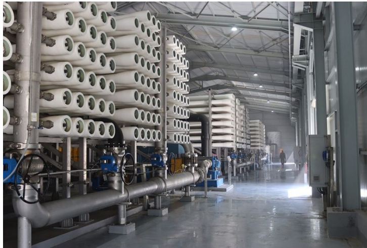
Figure 12: les châssis d'osmose inverse
