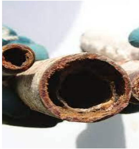
Figure II-6 : Effets de la corrosion sur les tuyaux de refroidissement.
