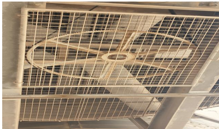
Figure III-4 : aéroréfrigérant (des ventilateurs).
