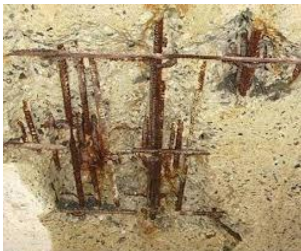
Figure II.1 : Corrosion des armatures due à la salinisation des sols
