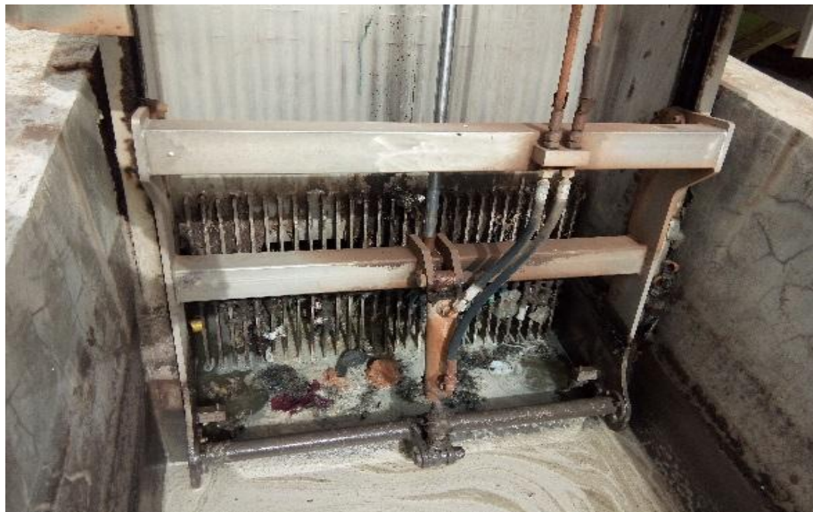
Figure I. 2 : dégrilleur fin mécanique.
