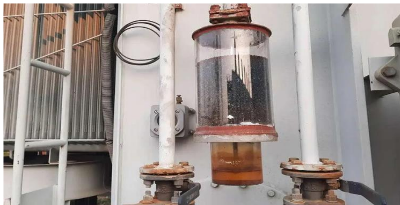
Figure (III. 8) : humidité dans l'huile d'isolation
