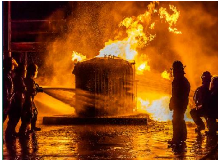
Figure (III. 1) : Déclenchement d'incendie au niveau du transformateur
