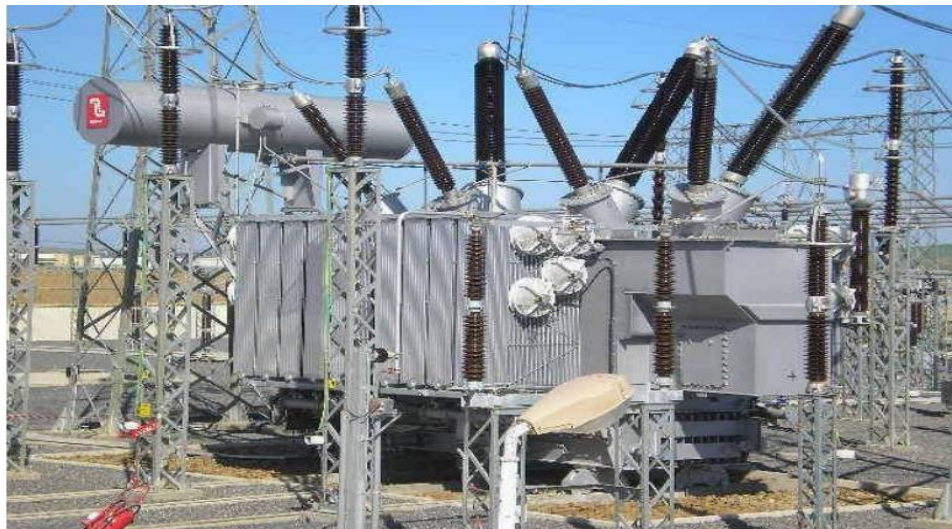
Figure (I.21) Autotransformateur [15]
