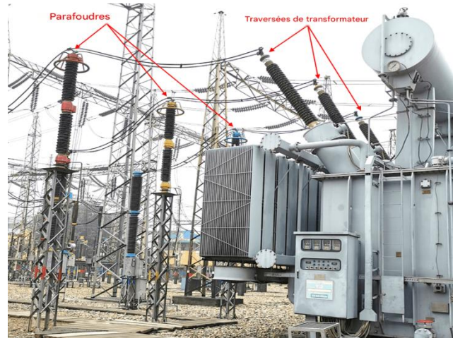
Figure (II.40) parafoudres protégeant un transformateur de puissance
