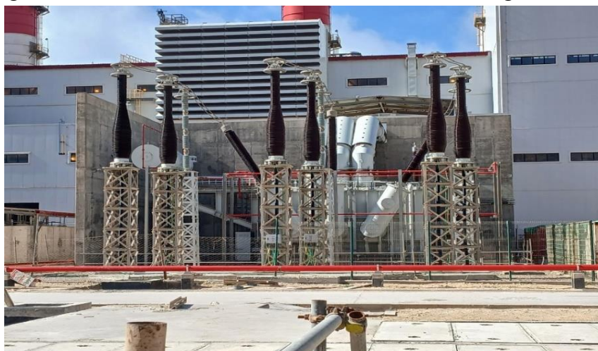
Figure (II.33): Le transformateur principal de cycle combiné à étudier
