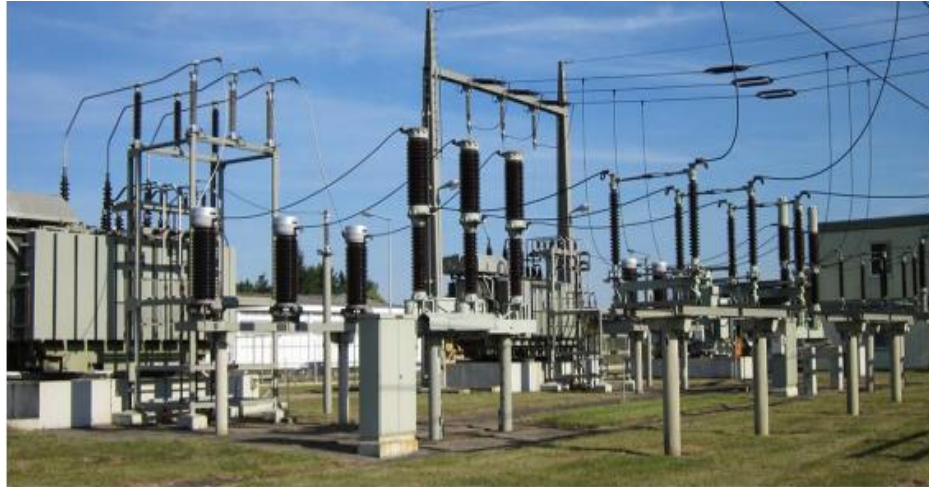
Figure (I.18) : poste électrique ouvert [14]
