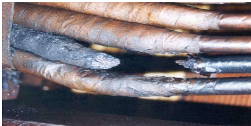
Figure (III.5) : Rupture de conducteur dans l'enroulement [19]
