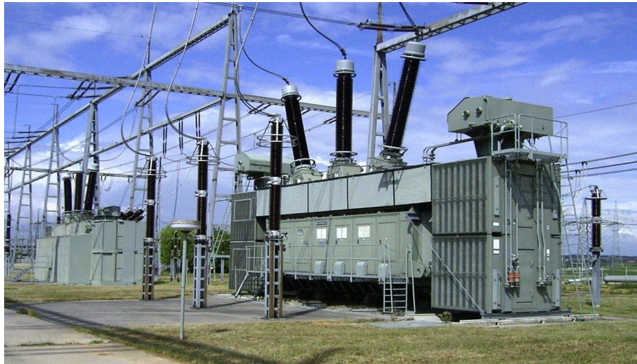
Figure (I.20) : Le transformateur de puissance [12]
