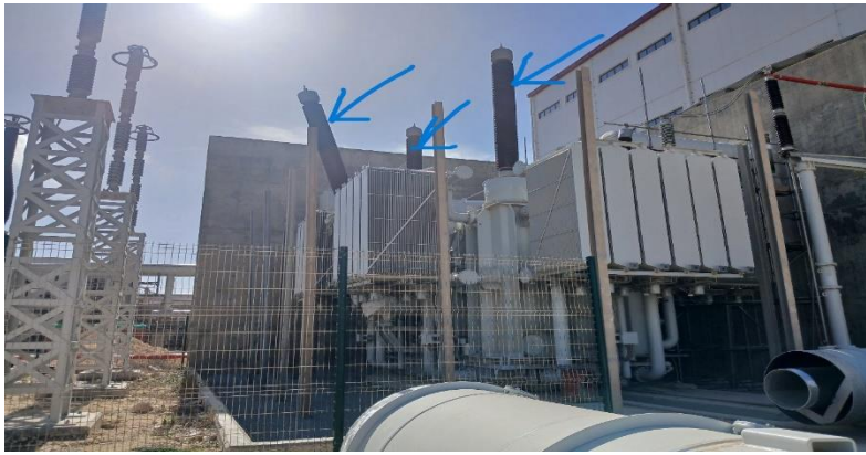
Figure (II.36) : Les bornes du transformateur principale
