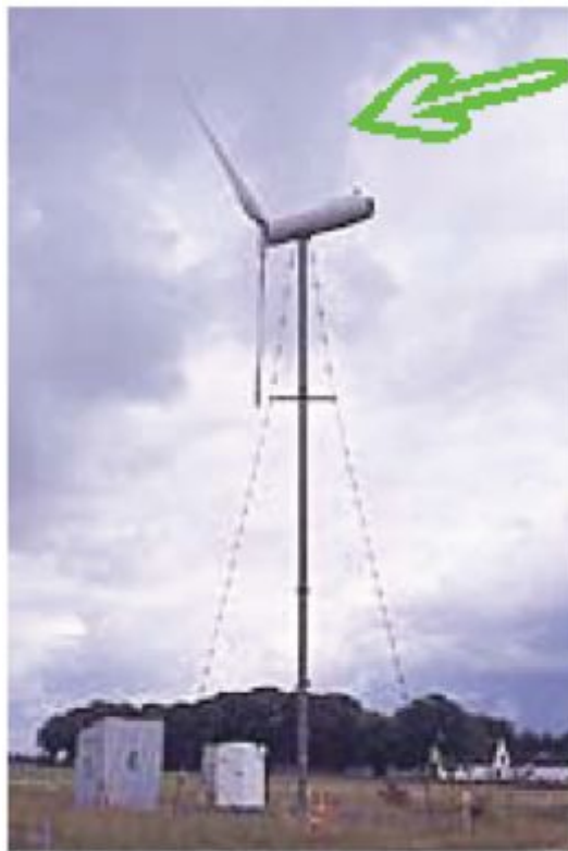
Figure I-9 : petite éolienne sous le vent de 22KW avec pylône léger haubané
