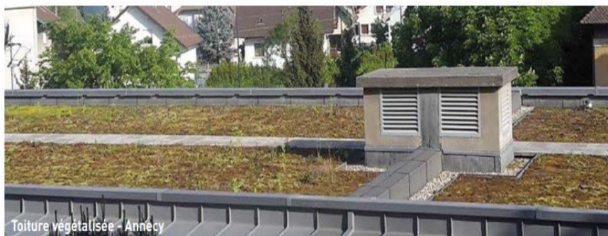
Figure 43 : Toiture végétalisée .source : SYMASOL, Gestion des eaux pluviales : Guide pour la mise en œuvre de techniques alternatives, 2016.
