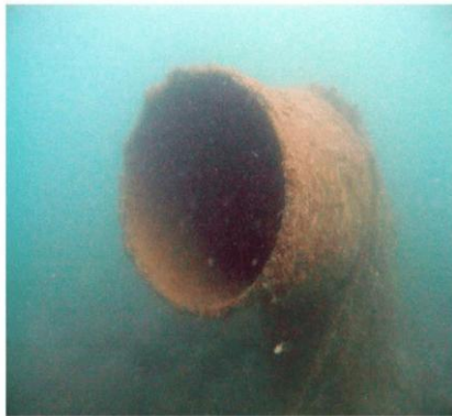
Figure I.10 Diffuseur de rejet de saumure
