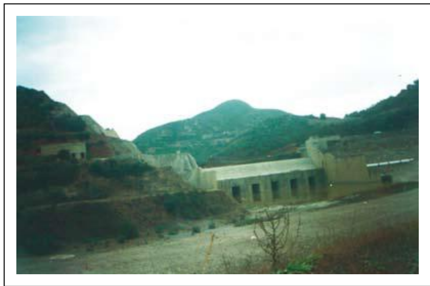
Figure I.22 : Six vannes de fond du barrage de Beni Amrane (Cliché de Remini – 2000)
