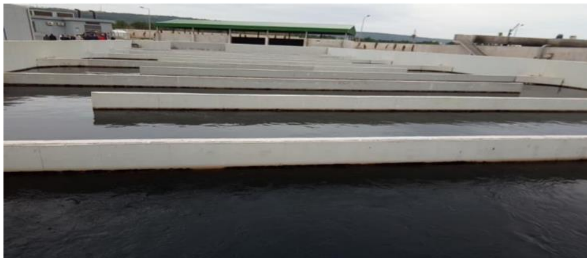
Figure II.10: Bassin de désinfection
