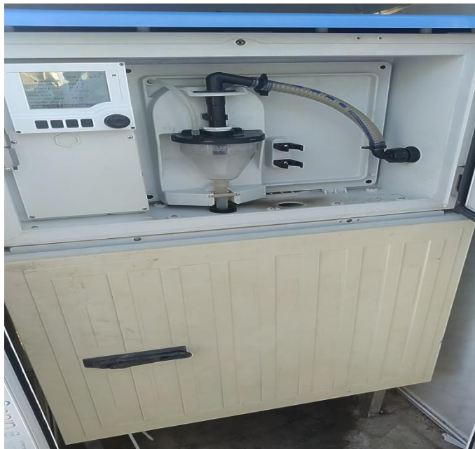
Figure III.1 : préleveurs automatiques à l'entrée et sortie de la STEP
