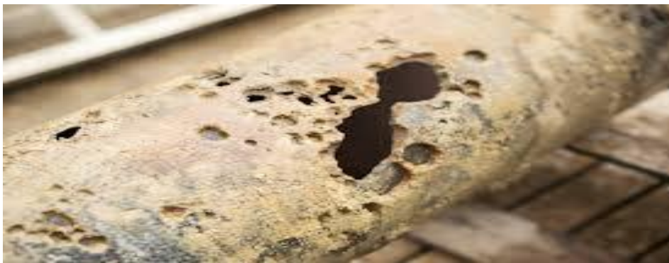
Figure III.5 : Perte de métal due à la corrosion par piqures
