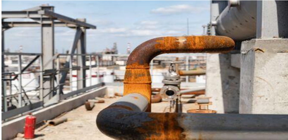
Figure III.4 : Perte de métal due à la corrosion externe
