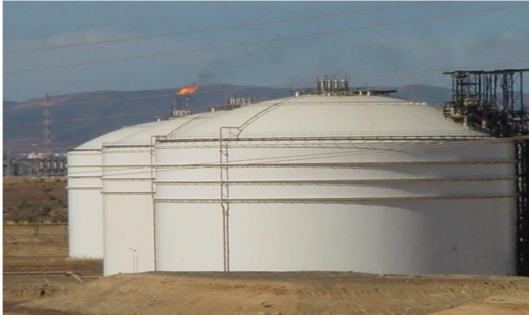
Figure I.7 : Bac de stockage
