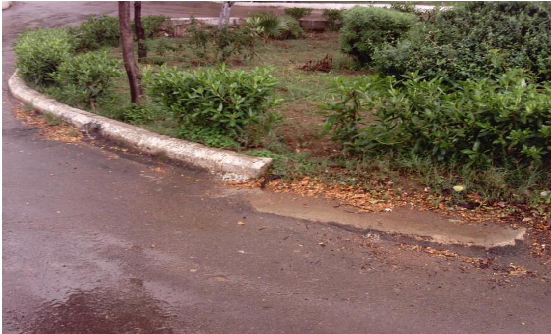
BORDURES DE TROTTOIR DETERIOREES. Bekkadra.tadmout.2015
