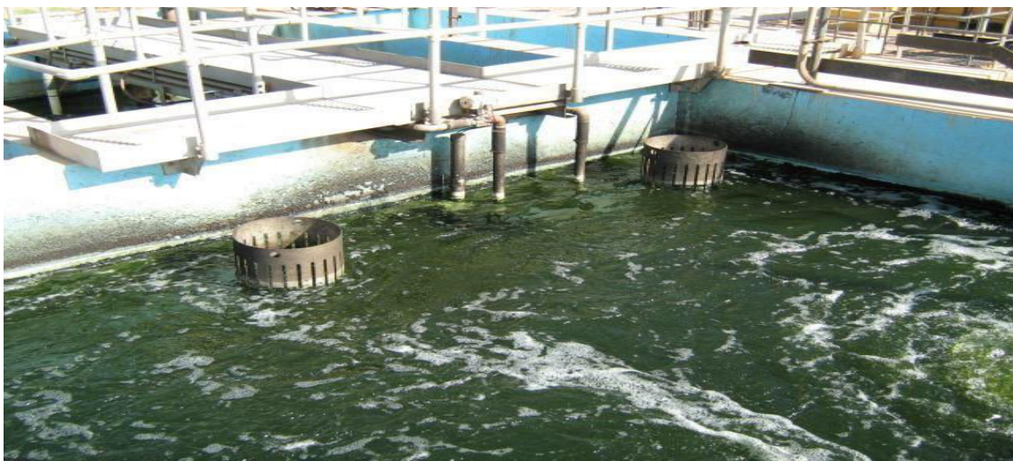
Figure 4. Bassin de dénitrification puis filtration
