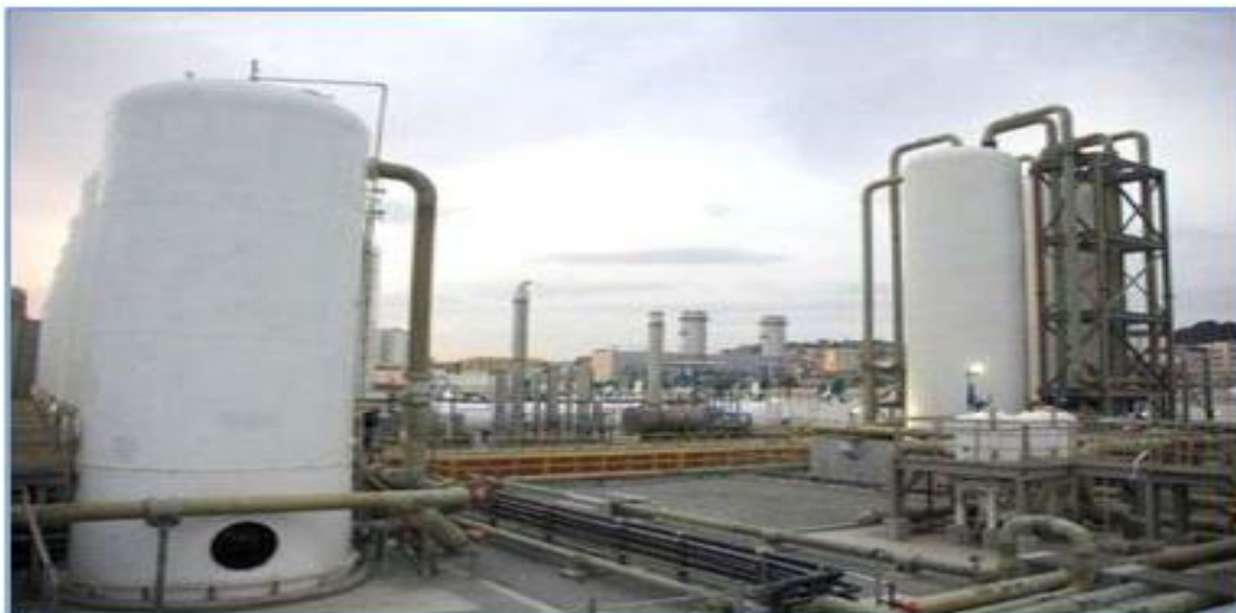
Figure N°3 : Stations d'épuration opérationnelles (1)
