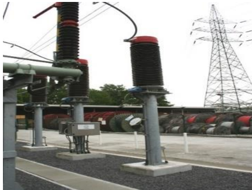
Figure II-17 : Transformateur de tension, de tension nominale 150 kV.
