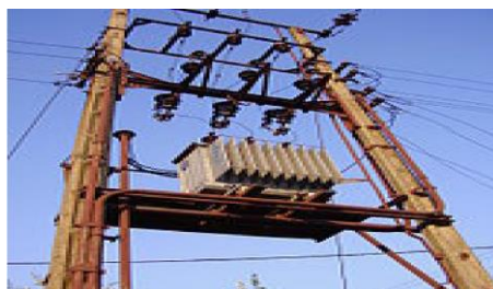
Figure I-10 : Transformateur dans un réseau de distribution sur poteau
