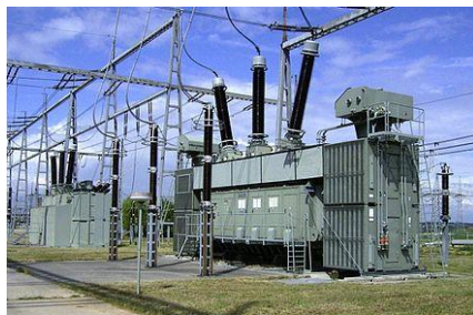
Figure I-9 : : Transformateur de puissance de 100 MVA dans un poste [9]
