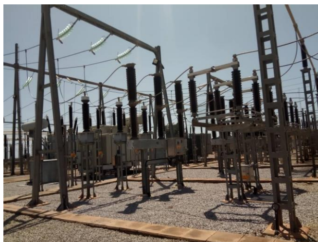
Figure I-27 : Photo réel poste de zagtouli 225 kV/90/33 kV
