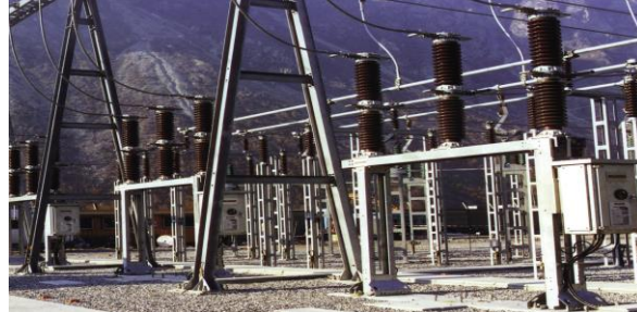
Figure I-6 : Poste HT à l'extérieur [8]
