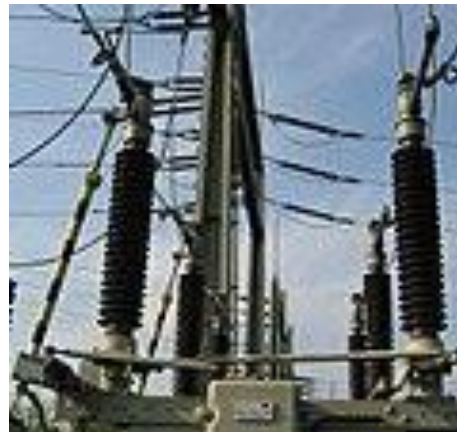
Figure II-10 : Sectionneur 110 kV ouvert [20].
