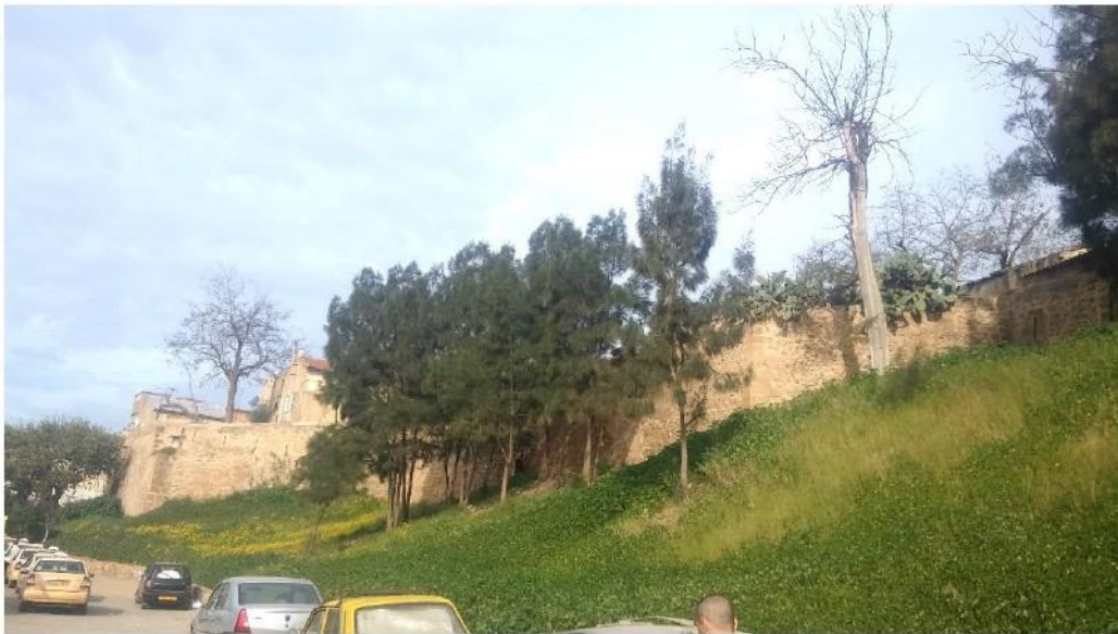
الصورة رقم: (32) انحدار السور الجنوبي
