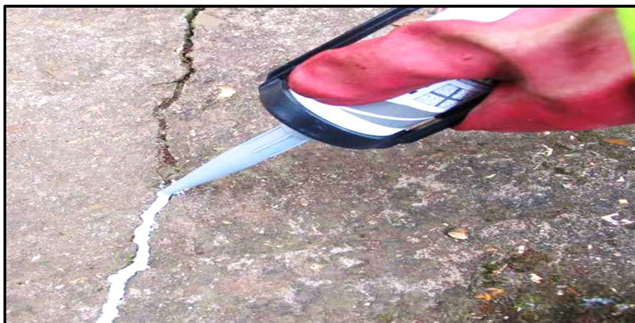
Figure I.11 : Le pontage (une des techniques de réparation)
