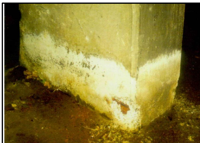
Figure I.3 : Conséquence de la réaction sulfatique interne
