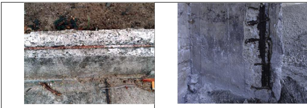
Figure I.10 : Corrosion de l'acier due aux attaques des sels
