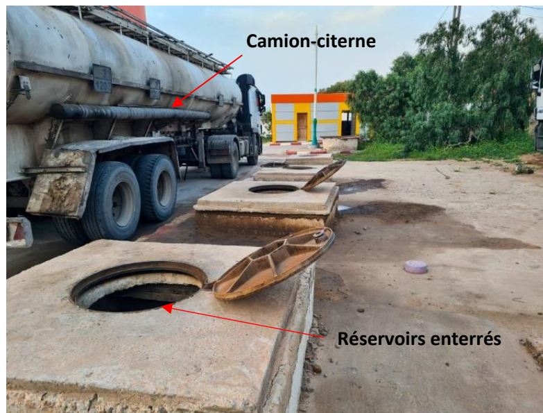
Figure 1 : Réservoirs aériens - enterrés (station-service Mostaganem).
