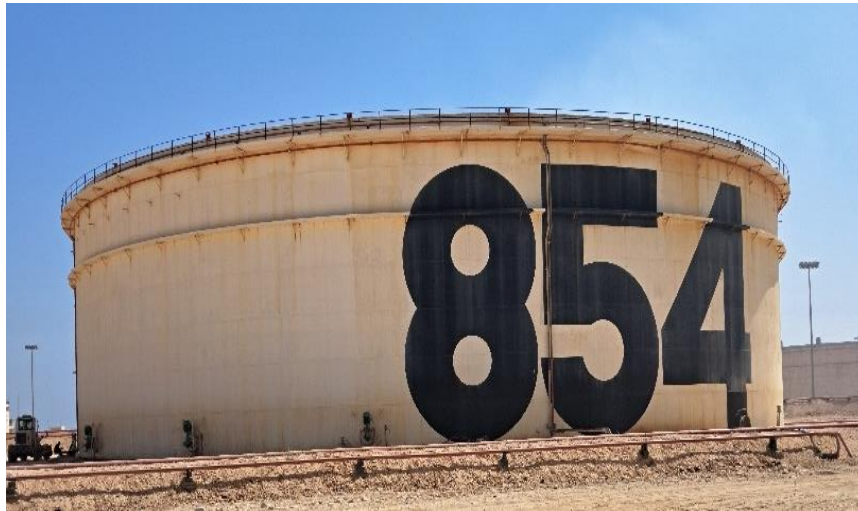
Figure 5 : Réservoir à toit flottante (NZ1-SONATRACH).
