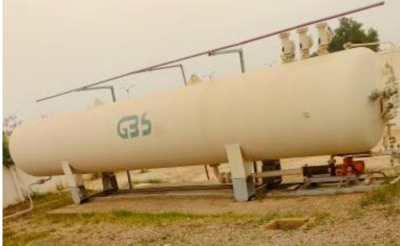
Figure 3 : Réservoir horizontale (station-service Mostaganem).
