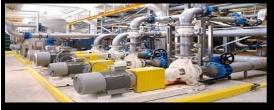
Figure I-10 : Système de pompage de l'eau de mer.
