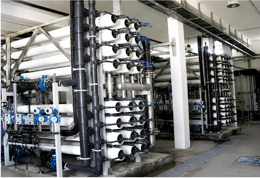
Figure I-16 : Châssis d'osmose inverse.
