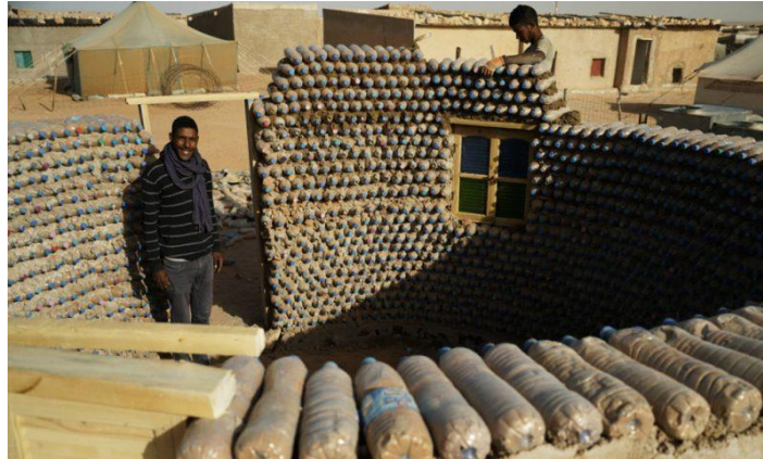
Photo 10 : de Tateh avec la maison en cours de réalisation avec la fenêtre et la porte 9
