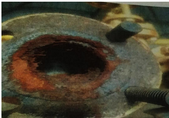
Figure II.4 : Corrosion dans T-162D.
