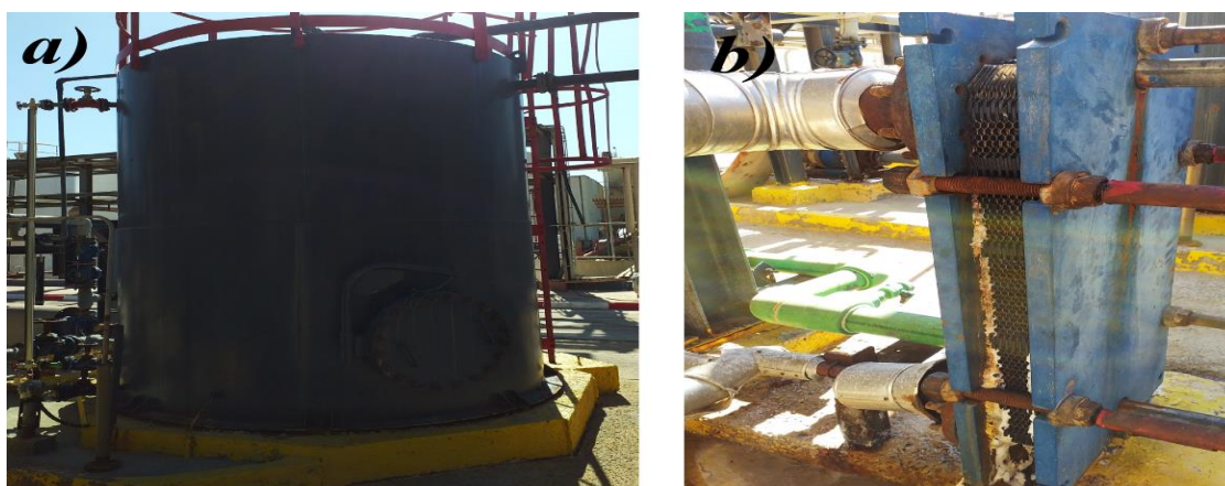
Figure I.17 : a) bac de stockage T-115, b) Echangeur de chaleur à plaque.
