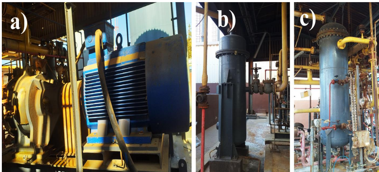
Figure I.23 : (a) Compresseur à anneau liquide; (b) Séparateur D-161; (c) Séparateur XD-161.
