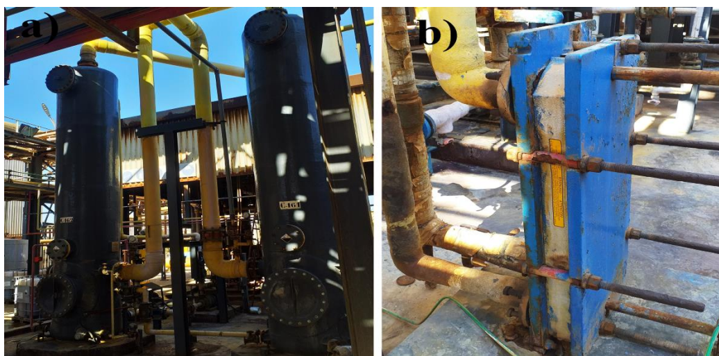
Figure I.21 : (a) Sécheur C-161 et C-162 ; (b) Echangeur de chaleur HE-161.
