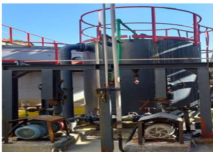
Figure I.14 : Bac de stockage T-110 avec deux pompes P-110A et P-110B.
