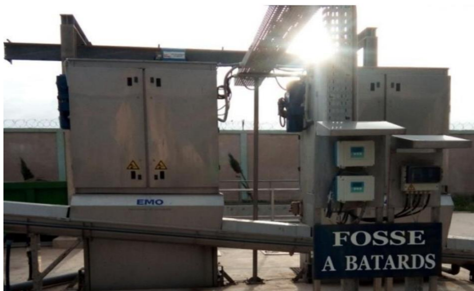
Figure 5. Dégrillage grossier (photo prise à la station)
