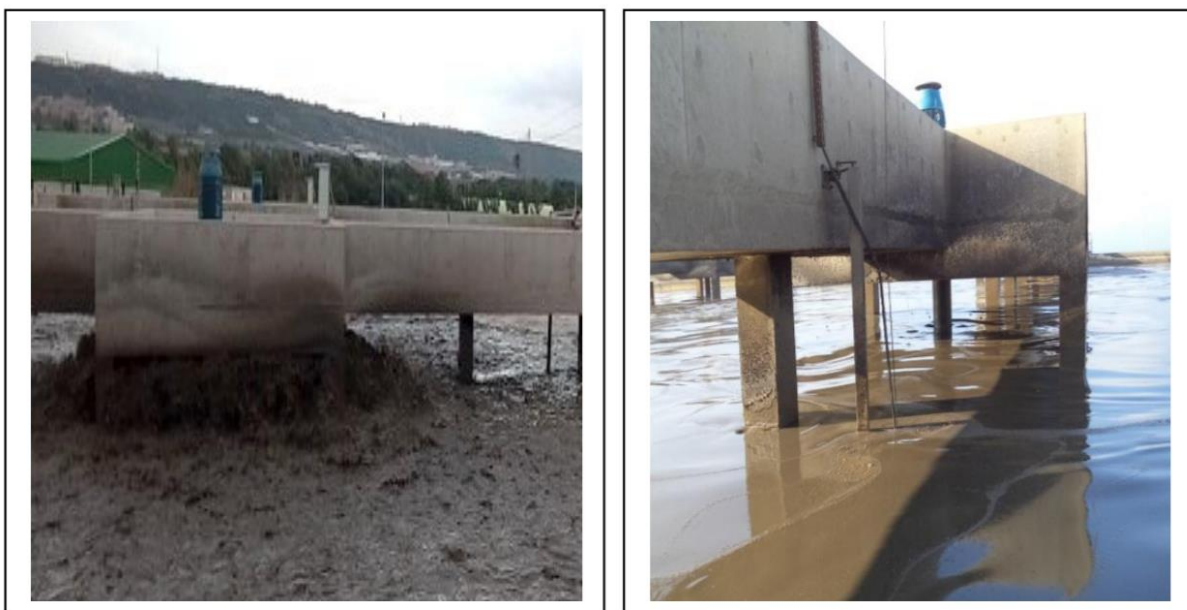
Figure 9. Bassin de stabilisation (photo prise à la station)
