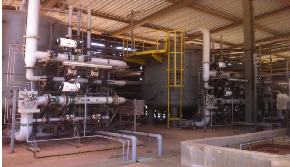
Figure I.4 : Photo de l'unité de déminéralisation
