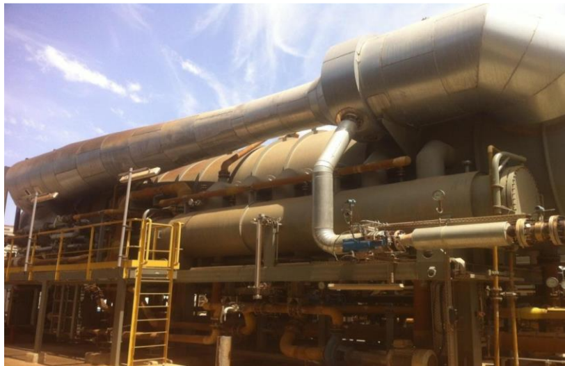
Figure I.2 : Photo de l'unité de dessalement par thermo-compresseur
