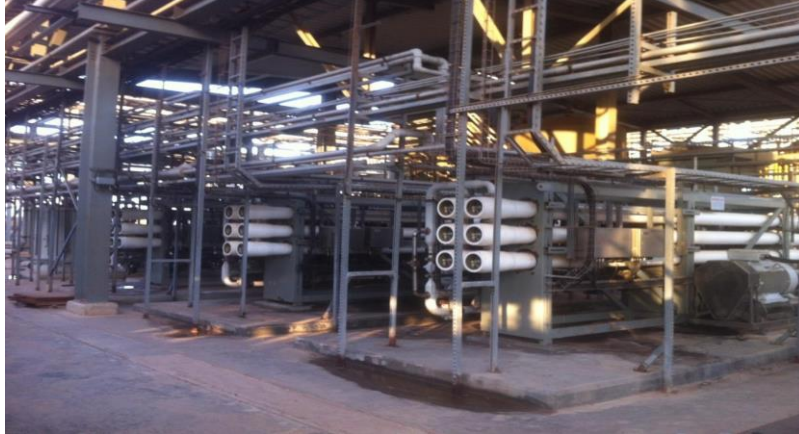
Figure I.1 : Photo de l'unité de dessalement par Osmose Inverse
