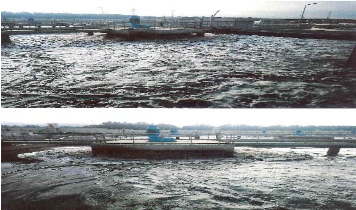
Figure I.8. Traitement biologique bassin aération.
