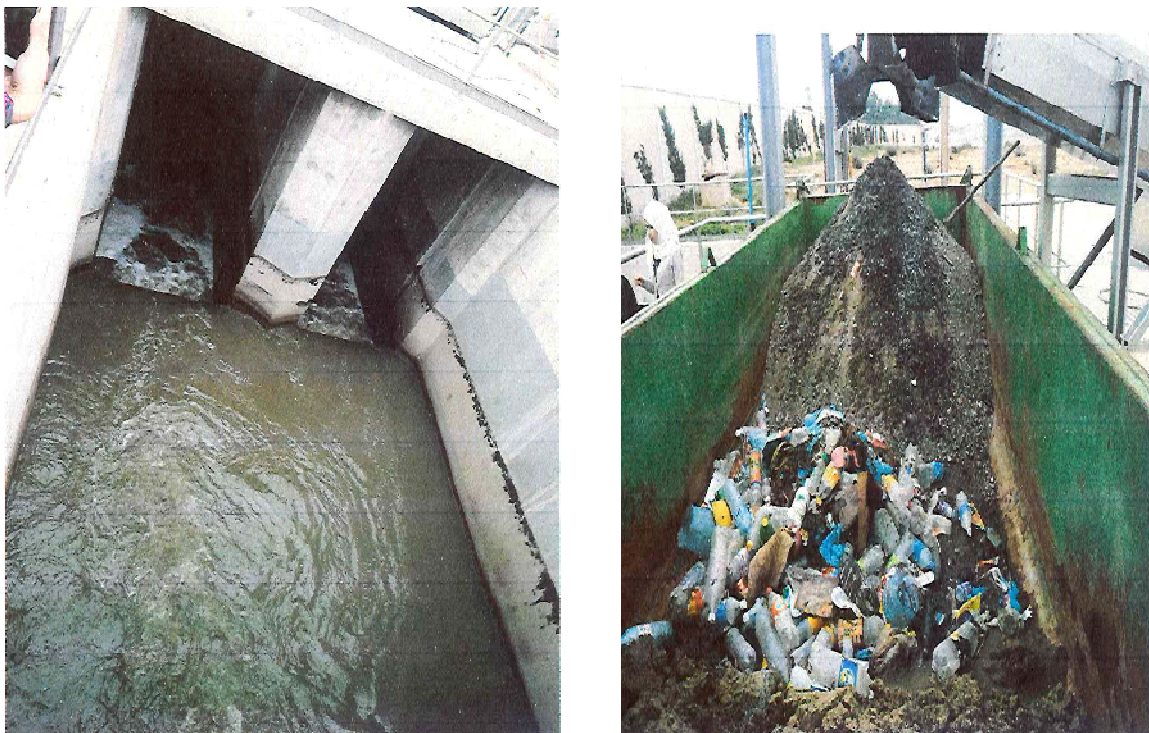
Figure I.4. L'entrée de dégrilleur grossier et ces déchets.
