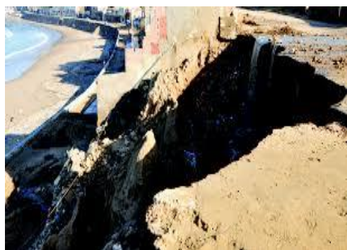
Figure162:les les eaux pluviales du chaabat Source :direction de l'hydrolique
