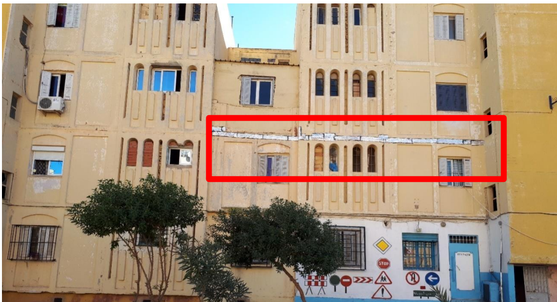
Figure 69: Problème d'étanchéité au niveau des parois extérieurs, Cas des ZHUN cité 5 juillet Mostaganem. - Source : Auteur
