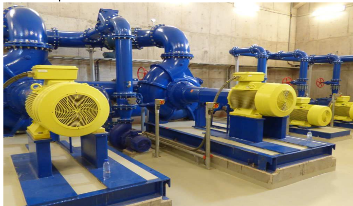
Fig. II.2. Station de pompage alimentée par le réseau électrique.
