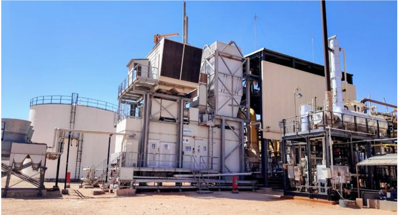
Figure 25: centre de séparation (Vue prise sur site lors du stage à In Amenas).
