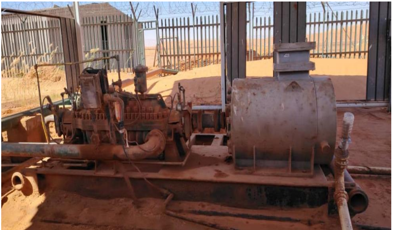
Figure 26 : Pompe et moteur situés au centre CS5(Vue prise sur site lors du stage à In Amenas)
