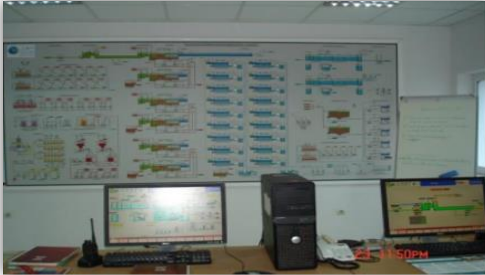
Figure. III. 16 Salle de contrôle
