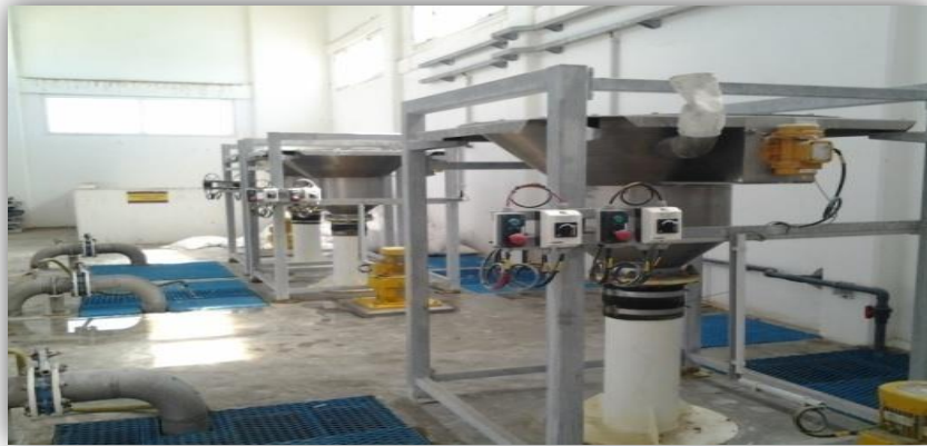
Figure. III. 9 Cuve de sulfate d'alumine
