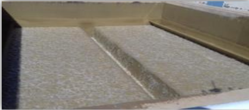
Figure. III.13. Lavage d'un filtre
