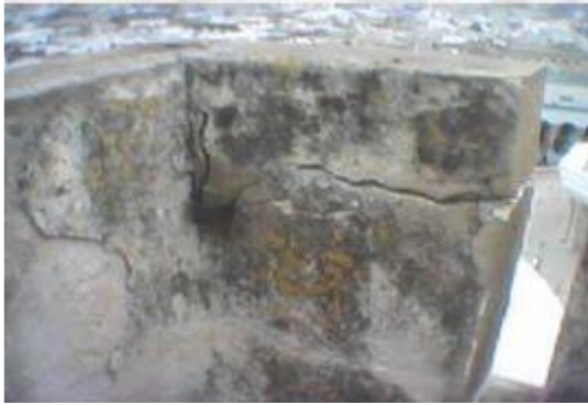
Figure 15: Fissure au niveau des acrotères
