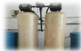
Figure(15): Osmoseur du service d'hémodialyse
