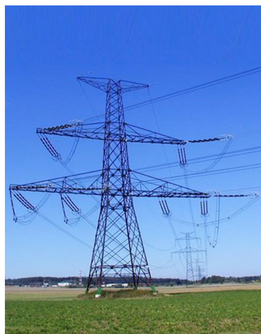
Figure 1.3 Tour de transmission d'énergie électrique en acier (Pylons, 2024)
