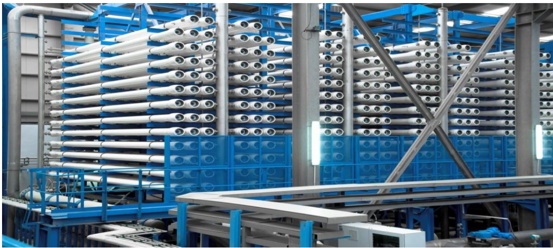
Figure II A .5 : Les châssis d'osmose inverse.
