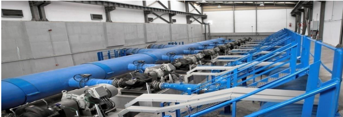
Figure II.A.7 : Pompage de l'eau minéralisée.
