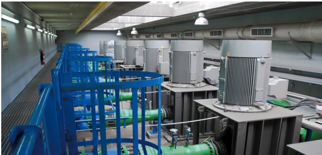
Figure II.A.3 : Le système de pompage de l'eau de mer.
