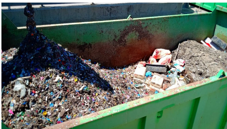
Figure 23 : Vue sur les déchets dans le dégrillage grossier
