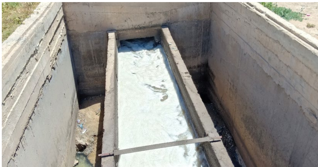
Figure 21 : Cabal d'entrée des eaux usées à la station
