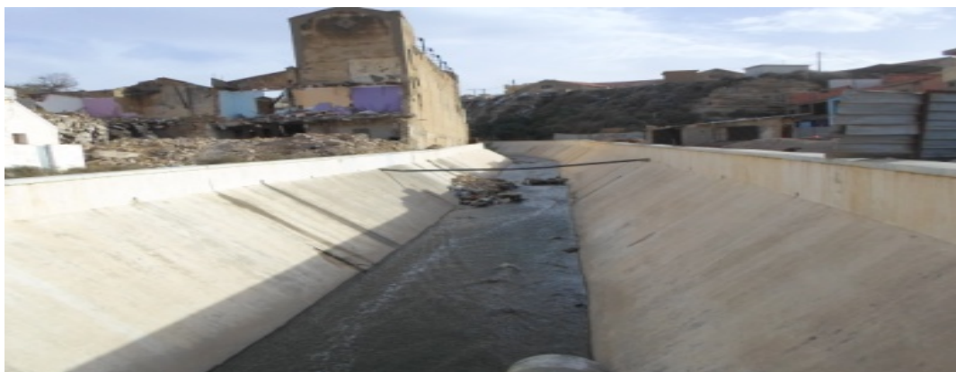
Figure 14 - Canal principal de l'oued Aïn Safra avant aménagement
