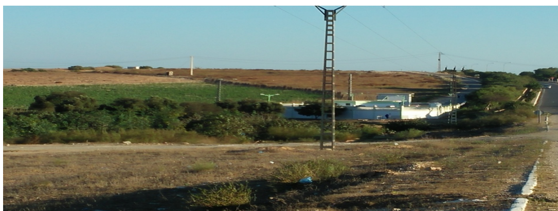
Figure 13 : Vue sur la station de relevage de Sayada
