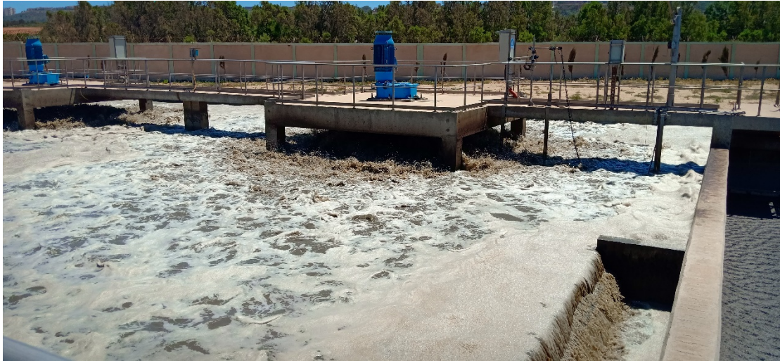
Figure 26 : bassin d'aération l'oxygène
