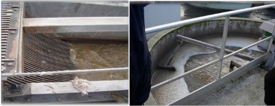
Figure103 : le prétraitement des eaux usées.
