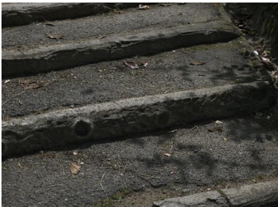
Figure 36 : Le pas-d'âne en ciment imitant des troncs d'arbres écotés : détail
