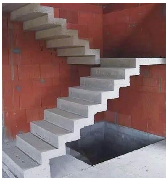
Figure 88 : photo d'escaliers avec dalle brisé Source : Recherche
