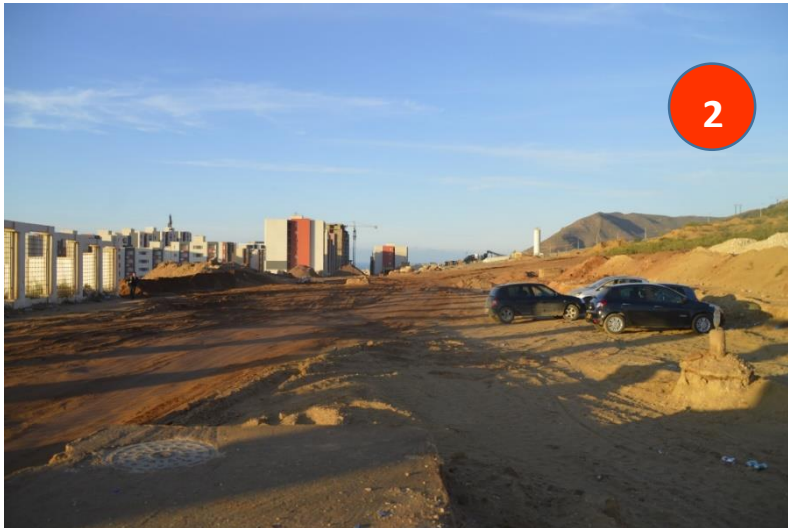
Figure 69: photo montre la piste qui est en cours de réalisation (prise par l'auteur).
