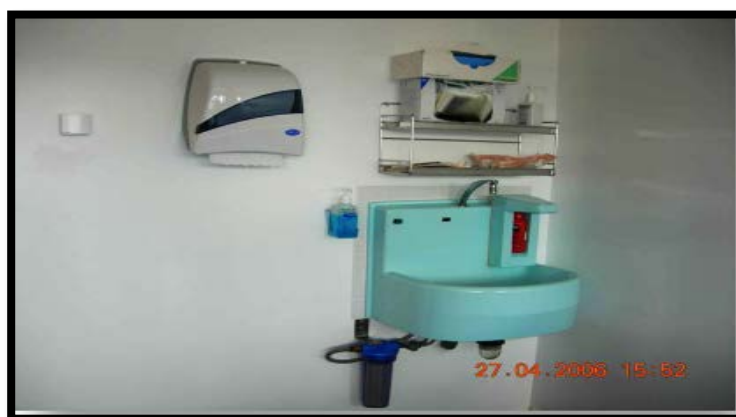
Figure 11 : Poste de lavage [7]
