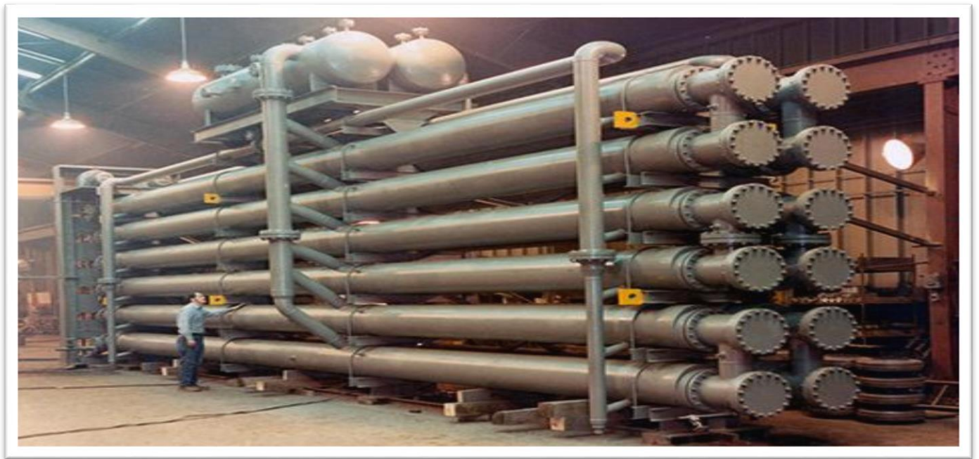
Figure IV.5 : échangeurs de chaleurs type « shillers »
