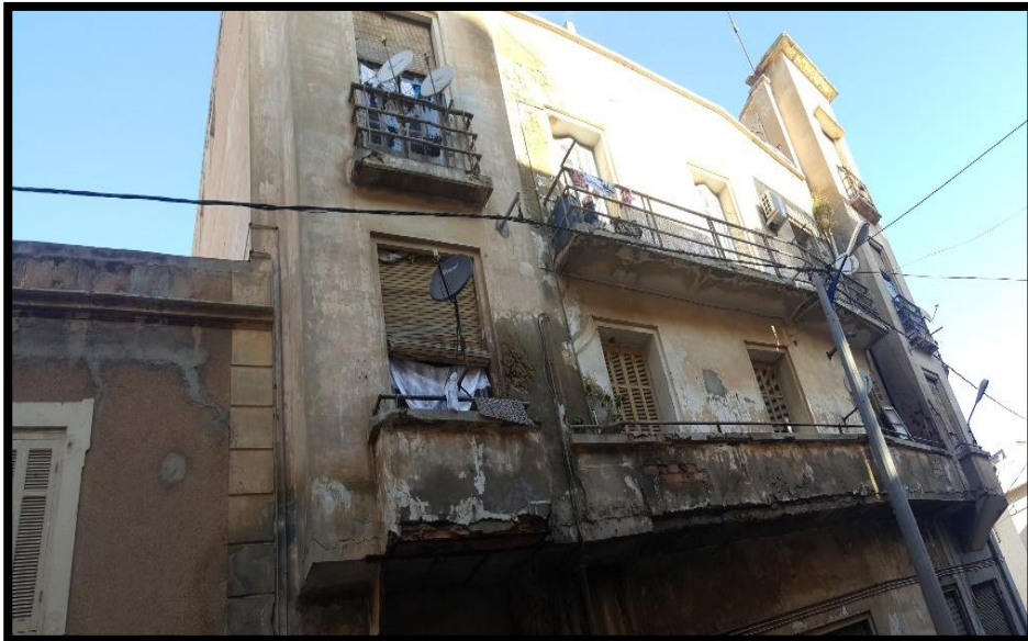
La dégradation de tissu urbain
