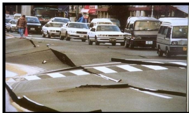
Figure 1.7 Endommagement de routes causé par la liquéfaction des sols à Kobe au Japon en 1995 (Source : USGS, 1995)
