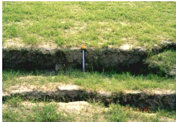
Figure I-15 Fissures considérables dans le sol à Nantou (Hsein, 2002).
