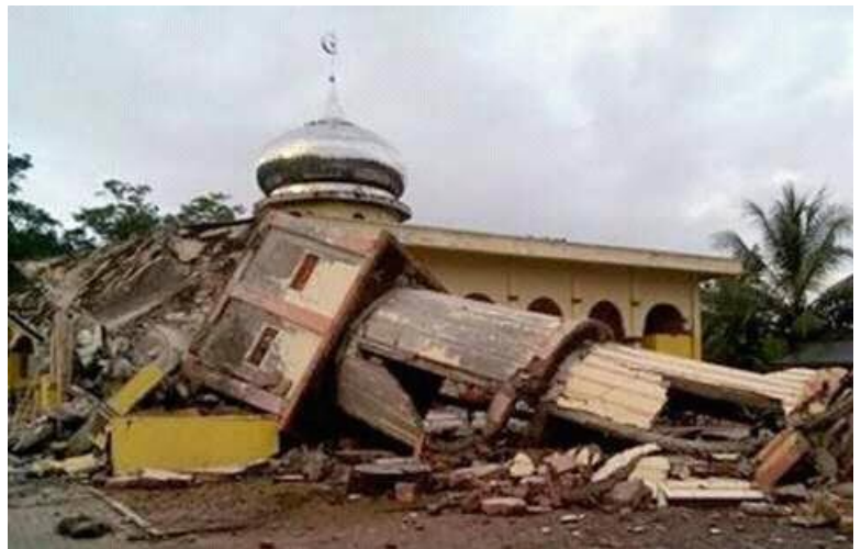
Figure I.17 : Effondrement total du musqué
