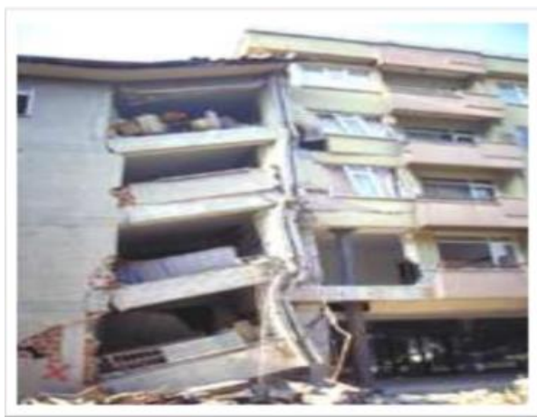
Figure I.14. Endommagement et rotation des poutres
