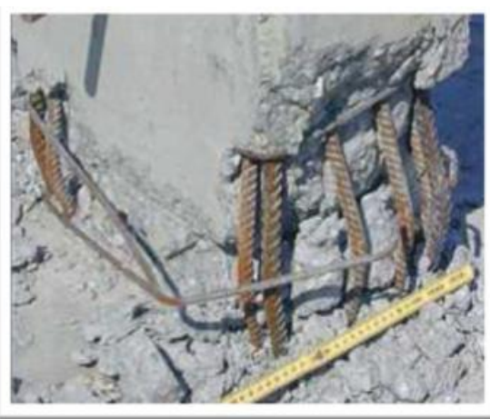
Figure I.15. Éclatement du béton et flambement des armatures à la base
